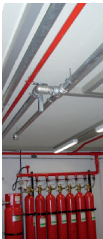
Dettaglio tubazioni Tyco Sapphire
