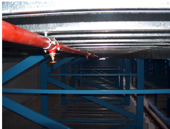
4. Dettaglio impianto SPRINKLER nelle scaffalature di un magazzino autoportante
